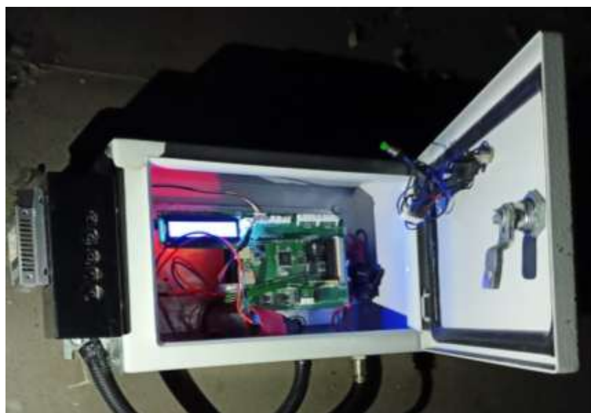
Рис.2. Монтажный блок аналитической системы контроля энергетической эффективности
